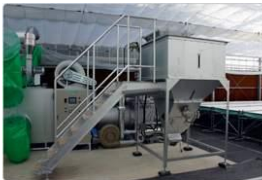
木質ペレットボイラー(暖房)
