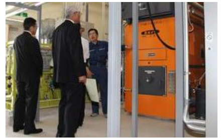
大町地域交流センターバイオマス設備
