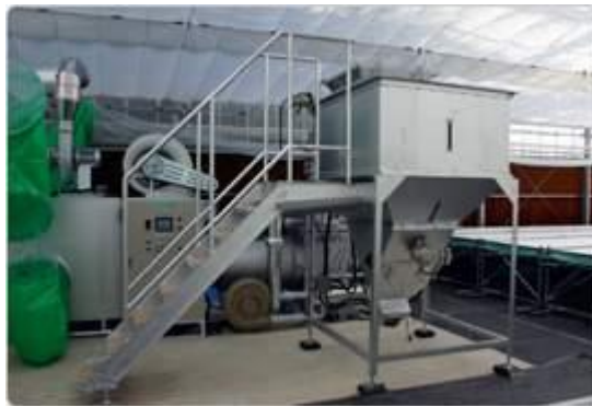
木質ペレットボイラー(暖房)
