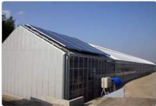
ビニルハウス屋根に 太陽光発電設備
